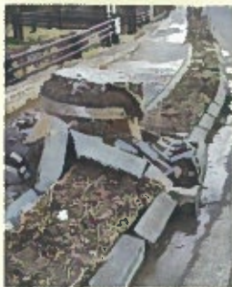
マンホール浮き上がり (田中後)
