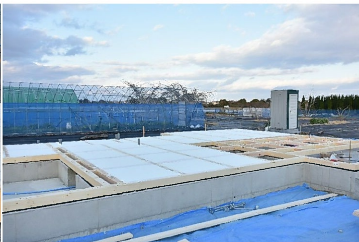
断熱材の敷込⑤ このように断熱材を敷き込んでいきました。
