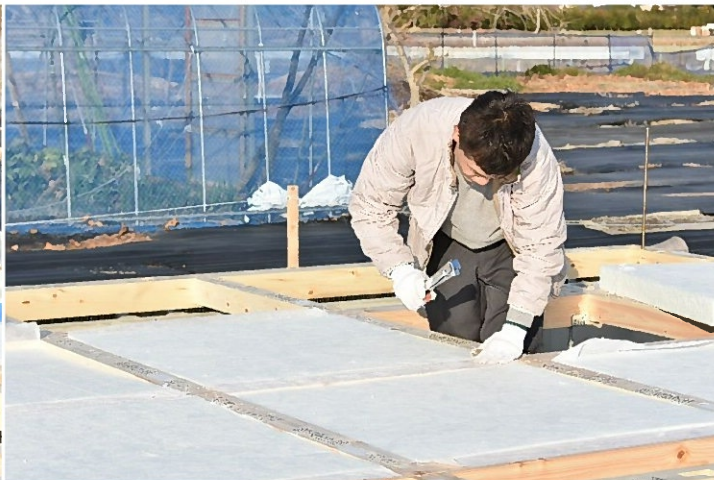
断熱材の敷込② 断熱材をタッカーで土台・大引きに固定しました。
