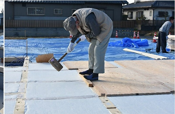
床下地合板の施工③ 割付はプレカット工場加工される際に決められ、土台・大引の芯配置となります。
