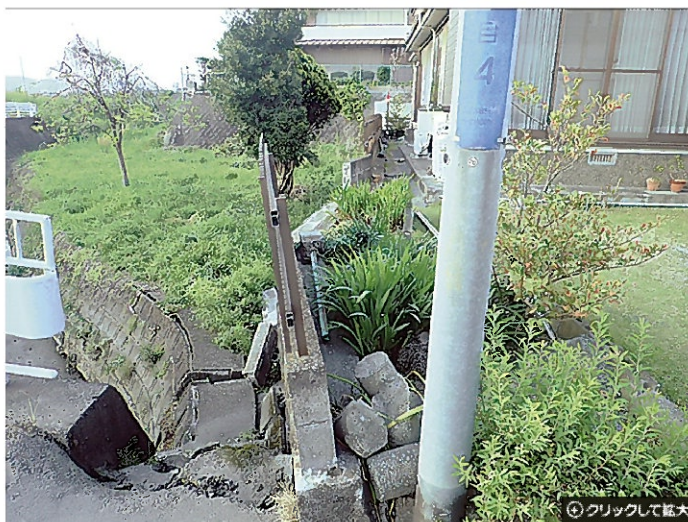
熊本市南区川尻地区の水路沿いに立つ住宅。液状化による側方流動で塀が水路の方にはらみ出している (写真：横山 芳春)
