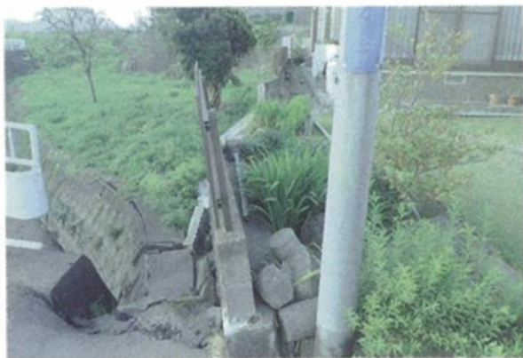
〔写真5〕側方流動で倒れた塀
